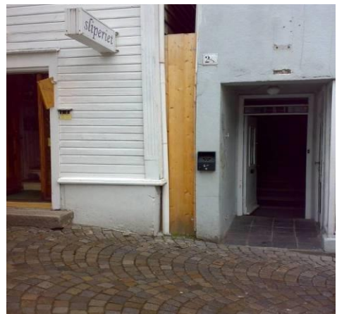
Tetting av smug/mellomrom ETTER. Er senere malt.
