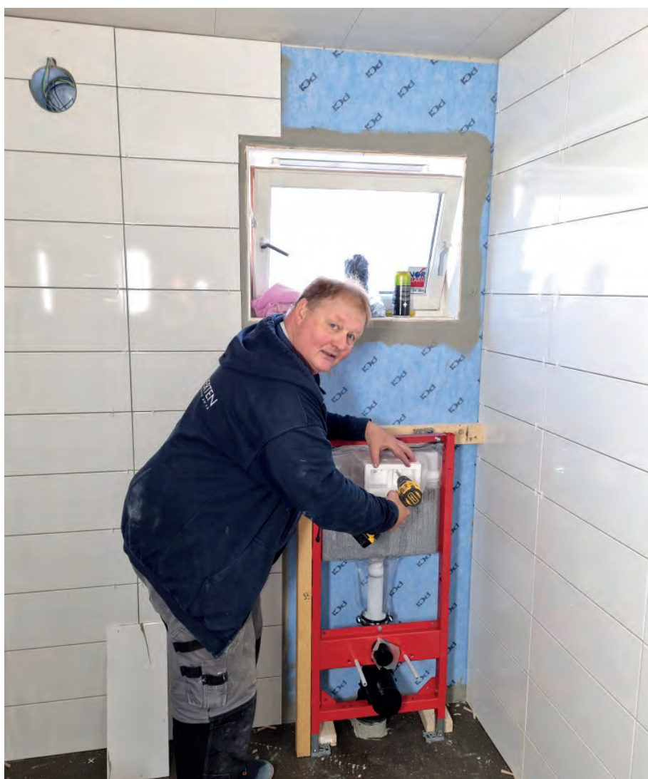
UTE PÅ OPPDRAG: Blant dagens arbeidsoppgaver var montering av ramme til veggklosett.
