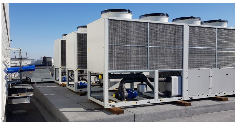
Figur 37 Eksempel på luft/vann varmepumpe- og kjøleaggregater med propan som kuldemedium ved Tillertorget i Trondheim (Storebrand Eiendom).
