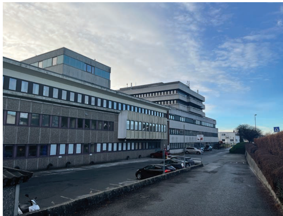
Vestbygget, fasade mot nord. Her er det i skybruddsplanen registrert utfordringer med overvann ved en 100-årshendelse.
