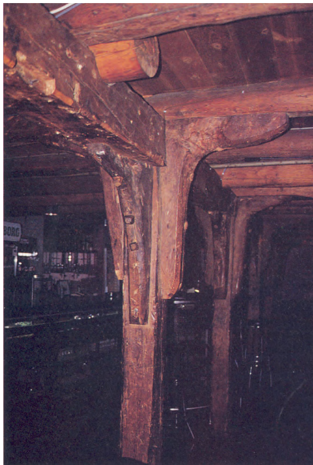
Detalj Nedre Holmegate 20 (Røde sjøhus). Karakteristisk bærekonstruksjon: avstiving med krumvokste knær. Foto: S.H.
