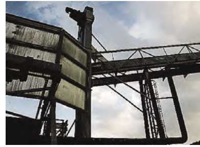
Skrettings transportbånd over jernbanen.
