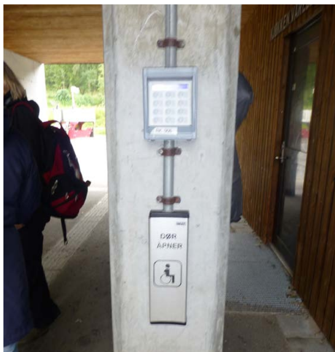
Bilde 42: Automatisk handikappåpning. Utfordringen er at den må plasseres lavt på veggen og kan dermed nås av barna.
