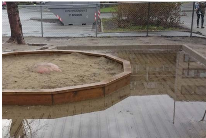
Bilde 45: Feil eller for lite fall gir vannproblemer. I tillegg klarer ikke vannet å renne vekk fra en tett overflate.
