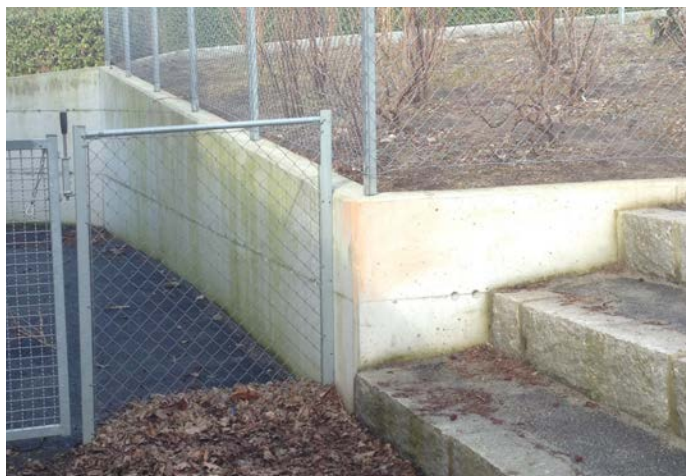
Bilde 47: Denne gjerdeløsningen gjør at barn kan klatre på murkanten og over gjerdet/porten.
