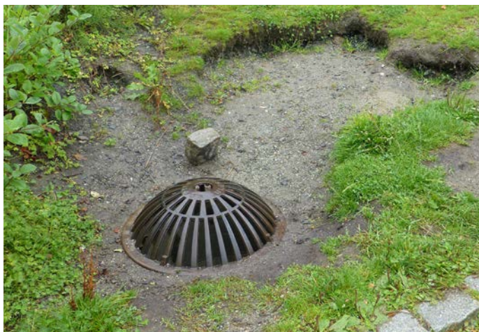
Bilde 46: Utvasking og slitasje ved kuppelrist.
