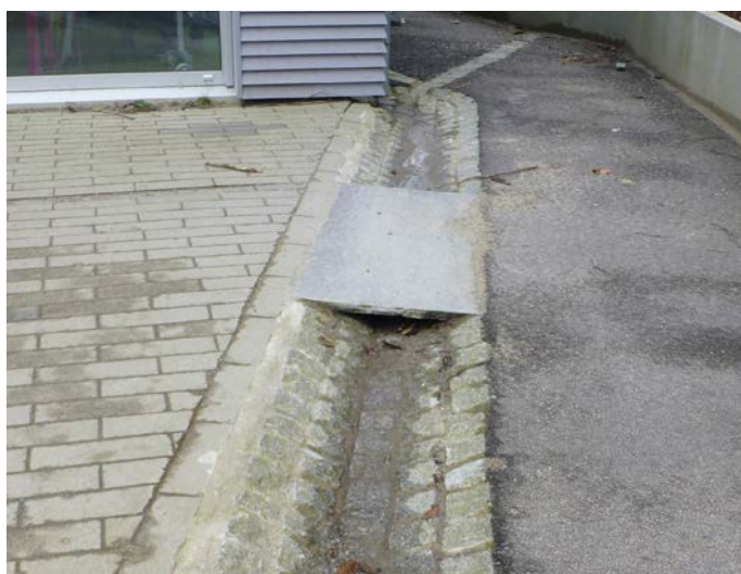
Bilde 16: Vannrenne med "bru" som sikrer tilgjengelighet.
