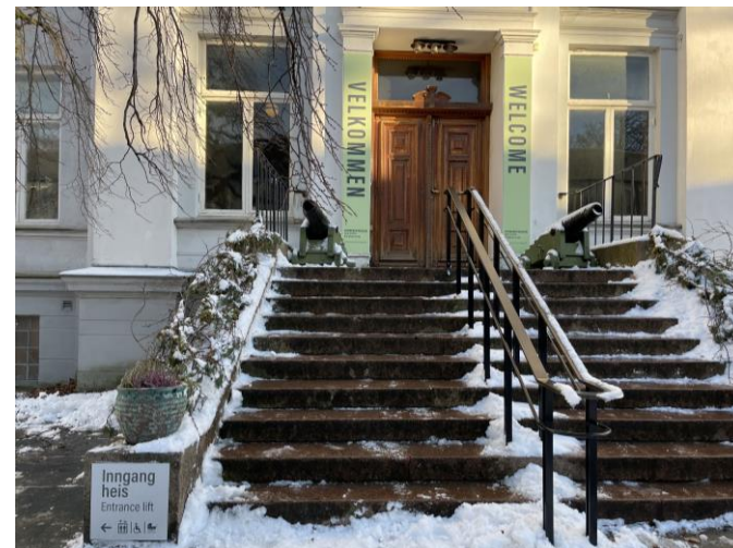
Manglende universell utforming for å komme inn på museet. Foto: Multiconsult
