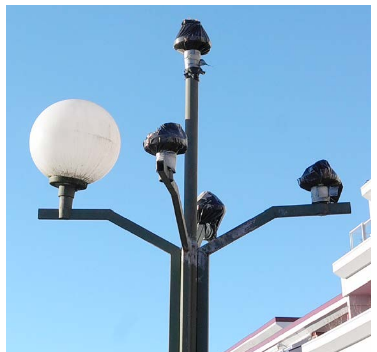
MANGLER: Flere av gatelyktene mangler kupler og armatur.
