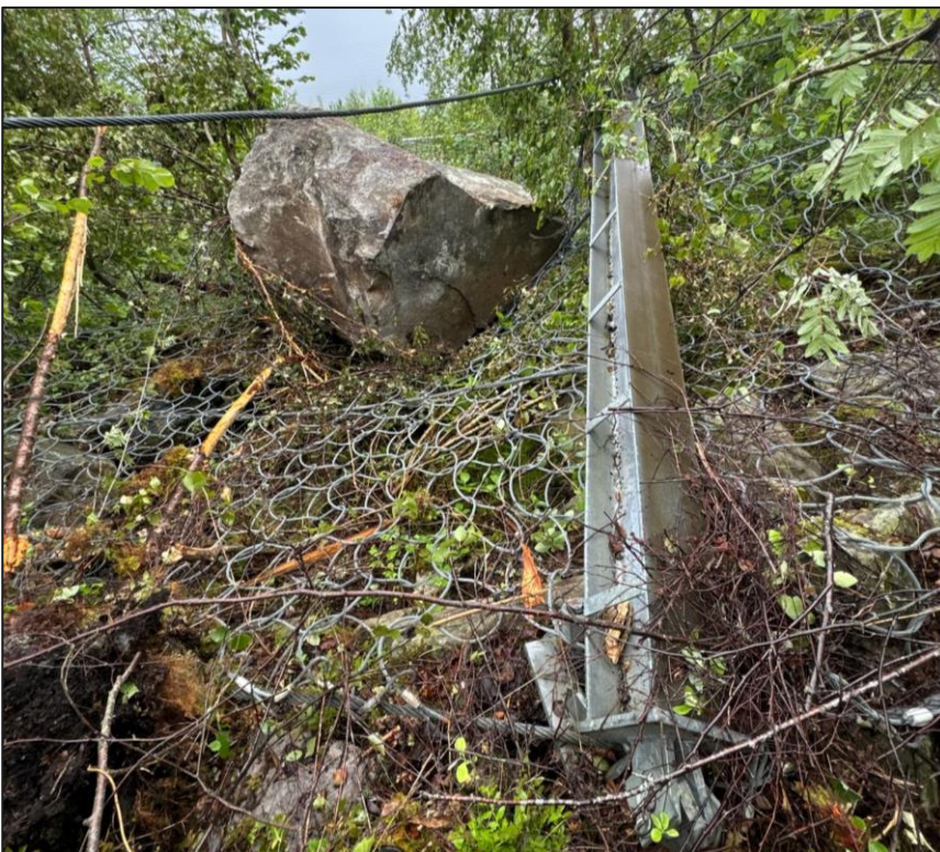
Foto 10. Ødelagt fanggjærde etter treff av steinsprang bak Tjueneset 24. Tatt 12.07.2024.
