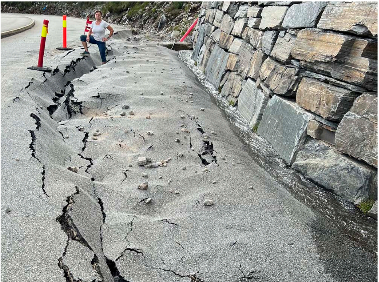
Bilde 5.20: Lokal vei i Sandnes som ble ødelagt etter et styrtregn i 2023 (Foto: Inger Anita Merkesdal) | Bilde 5.21: Erosjon av vei i Sandnes (Foto: Inger Anita Merkesdal)
