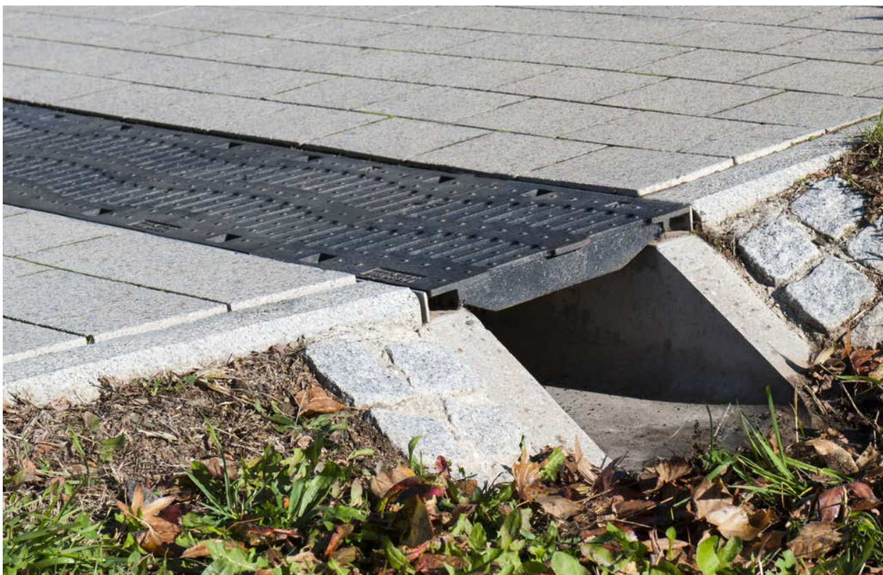
Bilde 4.9: Skybruddsrenne (Foto: Rambøll)
